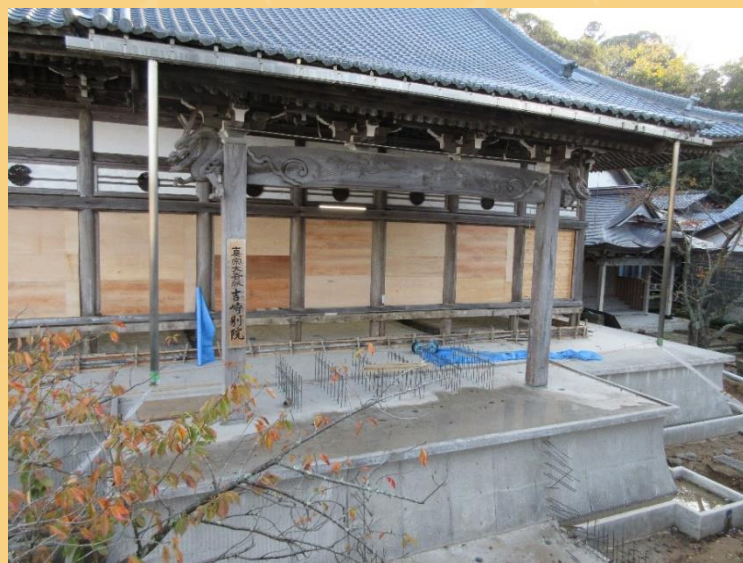
上 基礎工事を終え、向拝階段、浜縁設置工事に取り掛かる。
